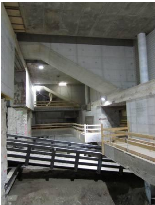
Blick auf die zukünftigen Stockwerke: „Vermarktungsebene“ (oben), Technikebene (Mitte) und die hier noch verfüllte Bahnsteighalle (unten)
